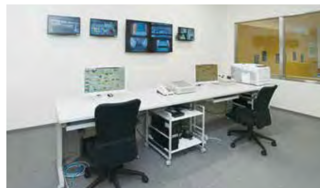
中央制御室 施設全体の処理ラインを管理します。機器の状態や処理の状況をモニタなどで監視し、安全で効率の良い運転を行います。
