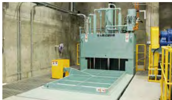
6 せん断式破砕機 可燃性粗大ゴミを切断して熱回収施設のごみピットへ送ります。
