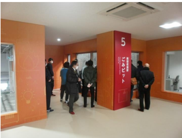
⑤ 焼却施設ごみピット
